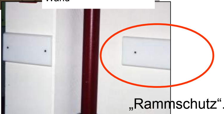
Stoßspuren an der Wand
